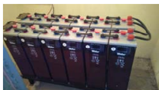
Ej sistema de baterías de alimentación
